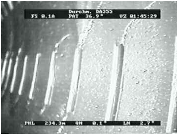
Abbildung 3: Rissbildung in Drainagerohrschlitzungen
